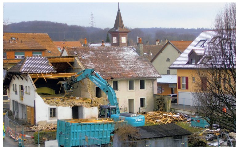
Le 4 février 2013, il lui manque déjà un bout de toit!
